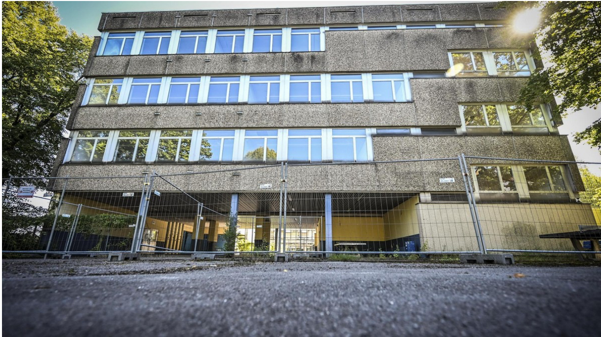
Die Waschbeton-Fassade drohte in Teilen abzufallen. Deshalb montierte man Elemente aus Stahl zur Sicherung, wie auf diesem Foto gut zu sehen ist. © FUNKE Foto Services | Kerstin Kokoska
