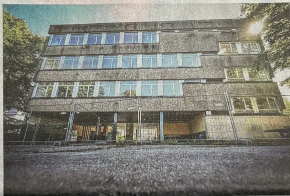
Die Waschbeton-Fassade drohte in Teilen abzufallen. Deshalb montierte man Elemente aus Stahl zur Sicherung, wie auf diesem Foto gut zu sehen ist.
